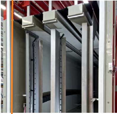
1 • Détail de cellule d'aspersion Detail of a sprinkling cell
