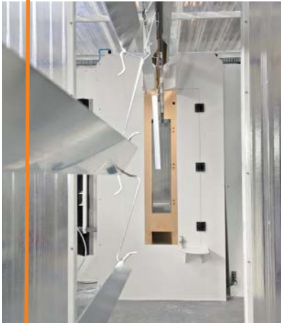
2 • Cabine de poudrage Powder coating booth
